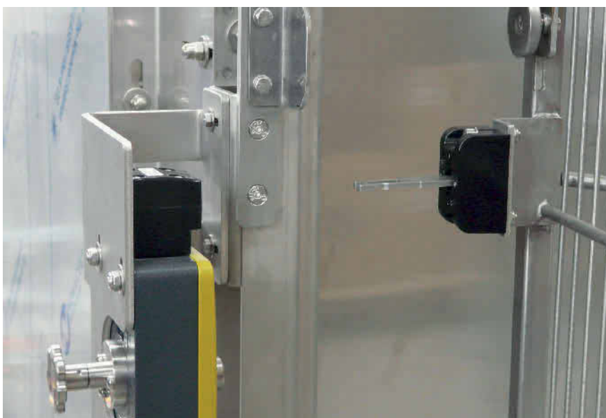
Bild 3 Die Schutztüren der Concordia-Anlagen sind mit der Ex STM 515 abgesichert. Foto: steute
